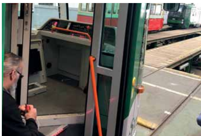
Instalace indukční smyčky v brněnské tramvaji
